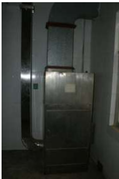
副厂区布袋除尘器
