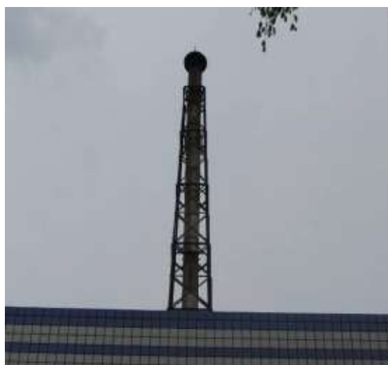
燃油锅炉废气烟囱
