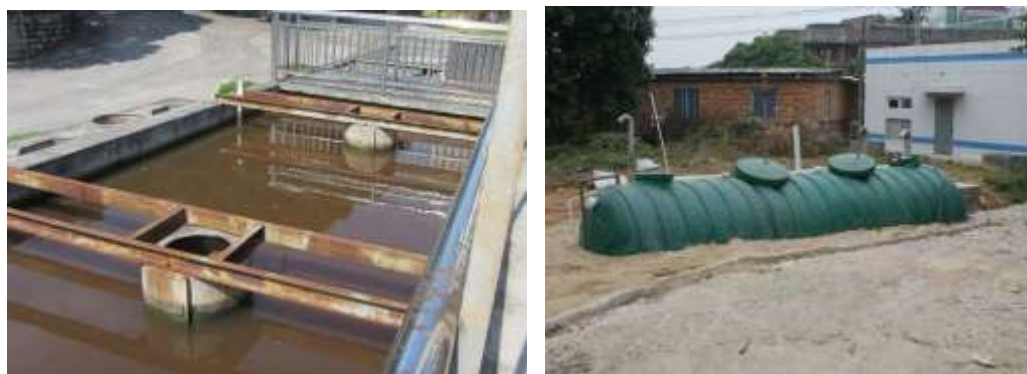
主厂区污水处理设施
